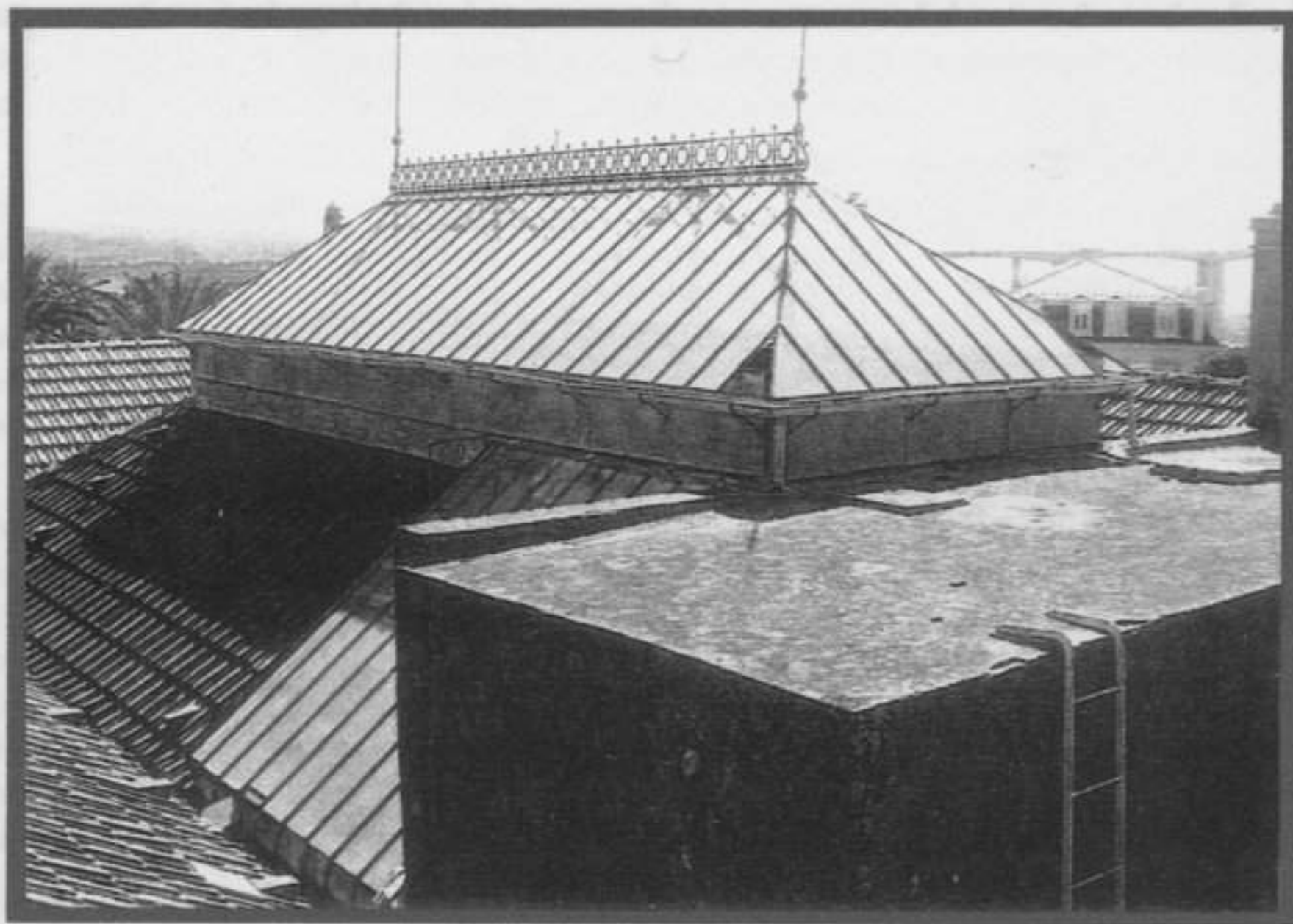
Fotografia n.º 1 – Vista da cobertura do Palacete Valle Flor sobre o Rio Tejo.
