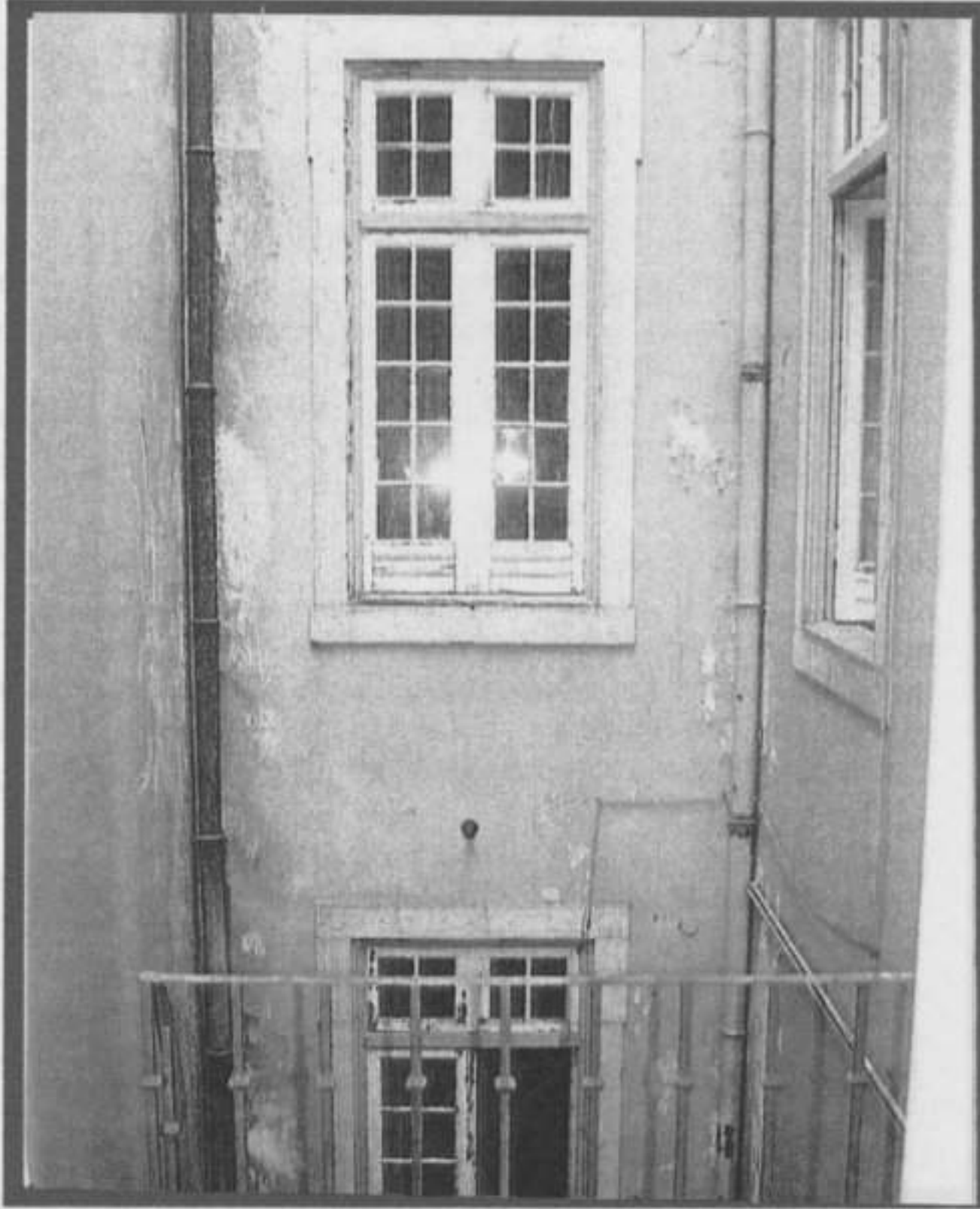
Fotografia n.º 8 – Interior do saguão, cuja pintura se encontra bastante degradada. As escadas de acesso ao rés-do-chão são levemente visíveis.
