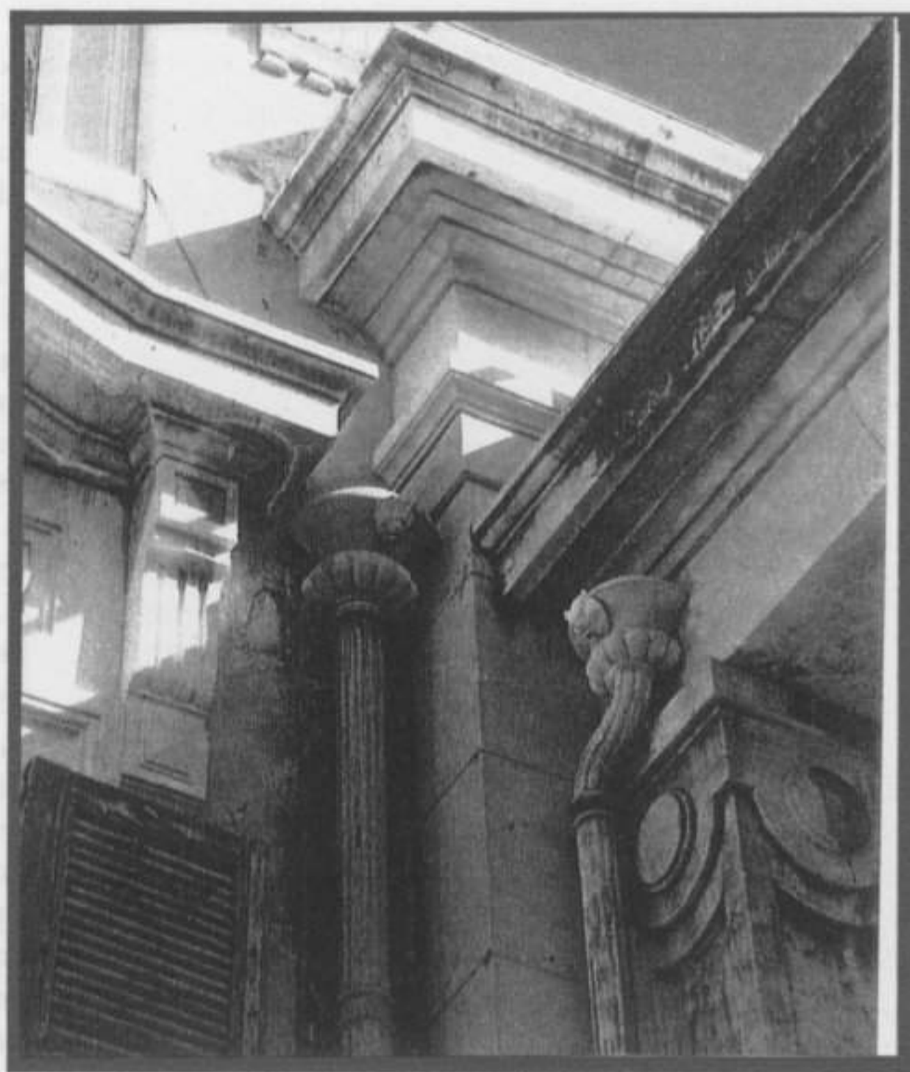
Fotografia n.º 10 – Pormenores da fachada poente, onde se evidencia a falta de manutenção do palacete.
