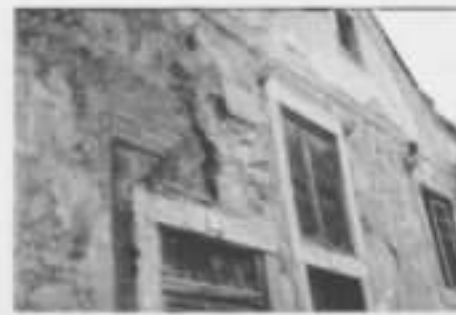
Fachada que apresenta patologias diversas
