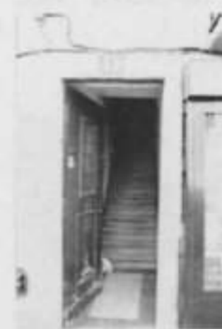
Escada em "tiro". A solução mais simples e económica, tanto a nível de estrutura como de aproveitamento de espaço. Período anterior ao pombalino.
