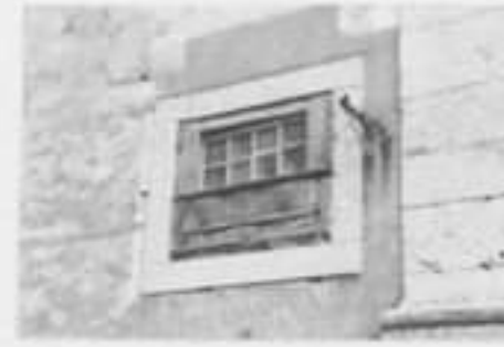
Janela com anomalias várias: apodrecimento e empeno do aro de madeira; sujidade do reboco; desgaste e fracturação da pedra de cantaria
