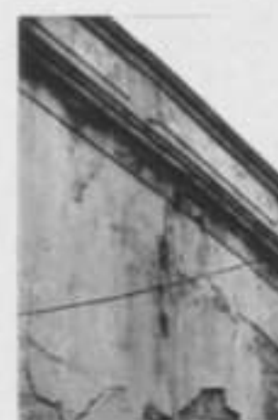
Patologia no reboco das paredes exteriores
