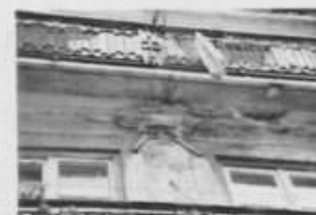
Anomalias várias nas cantarias
