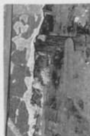
Apodrecimento da madeira da estrutura interna das paredes
