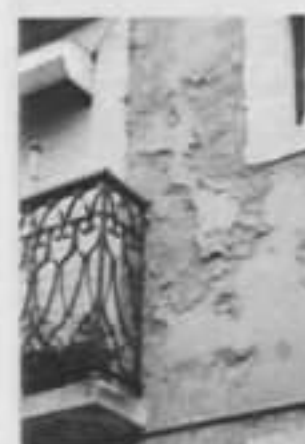
Patologia no reboco das paredes exteriores
