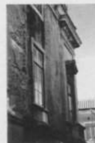
Fachada posterior com fortes sinais de degradação. Travessa das Mercês
