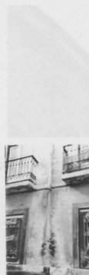
Efeitos da ausência de troços do tubo de queda
