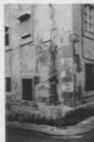
Esquina apresentando sinais de passagem de grandes veículos
