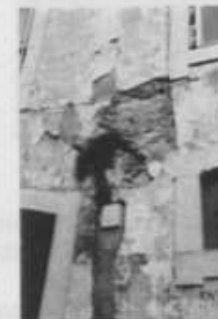
Degradação dos elementos exteriores do edifício
