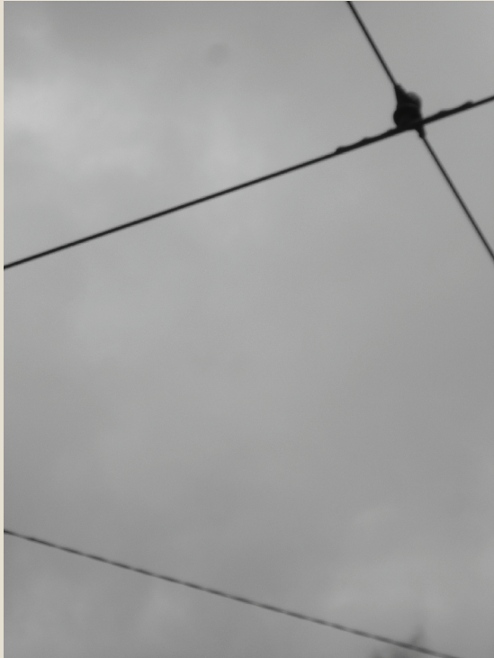
(Fig. 78) Cabos de carros-eléctricos, Lisboa.
