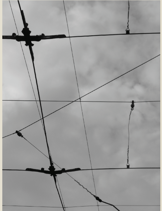
(Fig. 79) Cabos de carros-eléctricos, Lisboa.
